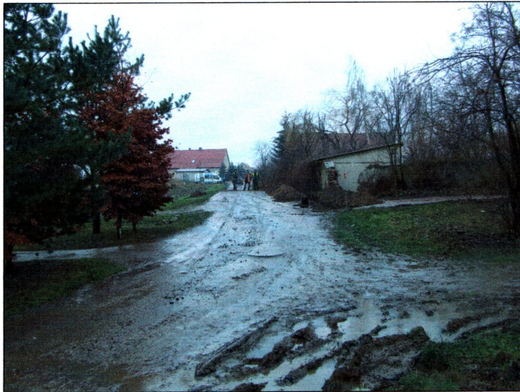
Fot. 1) Siemidrożyce gm. Kostomłoty dz. nr 80/1 przyłącze kablowe. Południowy kraniec wykopu. Widok z północy
