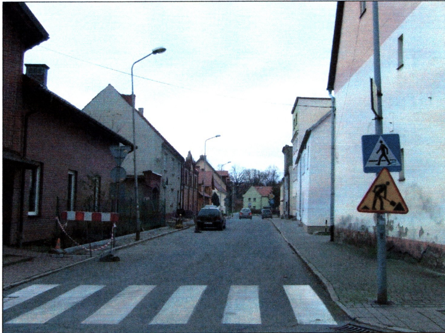
Fot. 1) Środa Śląska ul. Daszyńskiego dz. nr 76. Widok zachodniej części wykopów. Widok z południowego-zachodu
