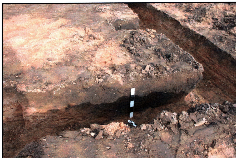
Fot. 10) Galków, gm. Miękinia dz. nr 402/17. Wykopy fundamentowe we wschodniej części inwestycji. Widok z południowego zachodu
