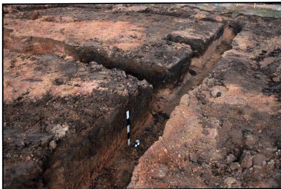
Fot. 9) Galków, gm. Miękinia dz. nr 402/17. Wykopy fundamentowe w północno wschodniej części inwestycji. Widok z południa
