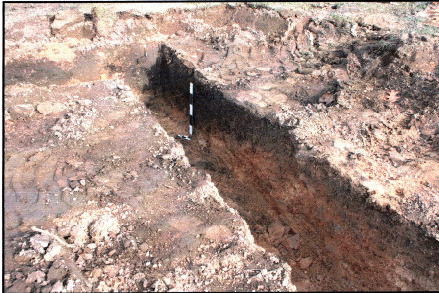
Fot. 11) Gałków, gm. Miękinia dz. nr 402/17. Wykopy fundamentowe w północno wschodnim narożniku inwestycji. Widok z południowego zachodu
