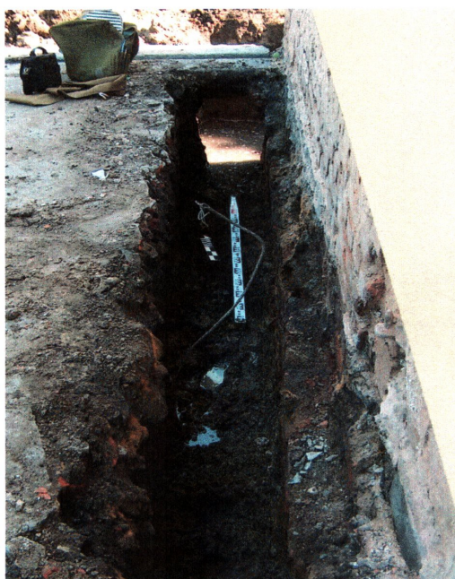
fot. 6 Wykop pod osuszenie ściany zachodniej budynku przy ul. Świdnickiej 18a, widok od południa
