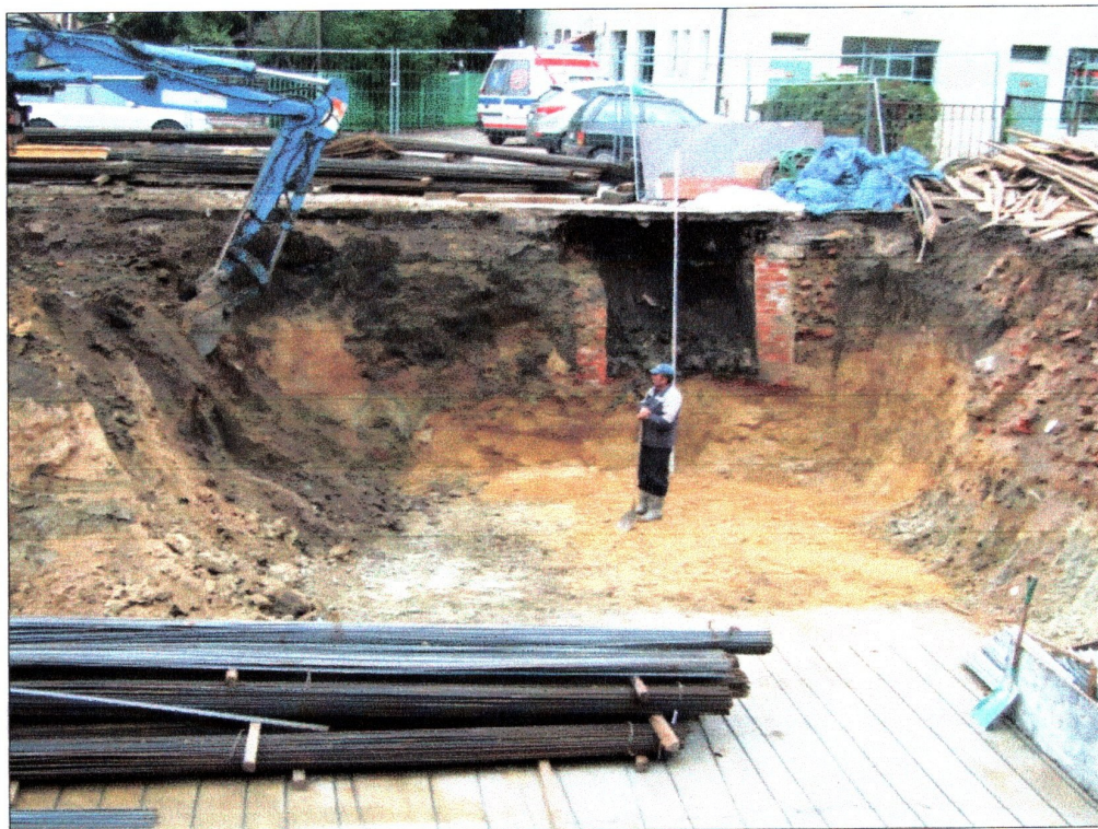
fot. 34 Nadzorowanie wykopu budowlanego w środkowej części inwestycji, w obrębie sondażu VI
