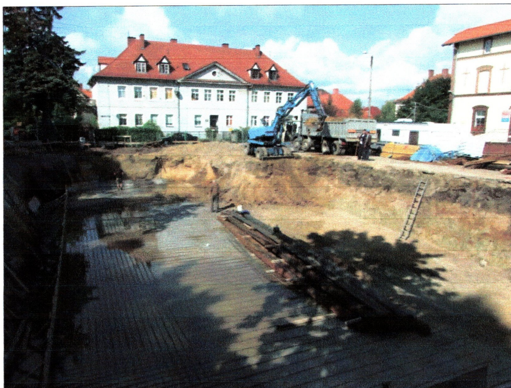
fot. 36 Nadzorowanie wykopu budowlanego w środkowej części inwestycji, w obrębie sondażu nr VII
