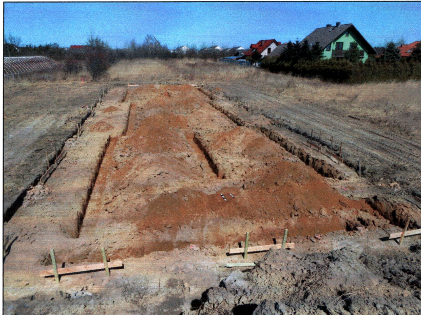
Fot. 4) Lutynia, gm. Miękinia, dz. nr 242/17. Obszar inwestycji po wykonaniu rowów fundamentowych. Widok z południa
