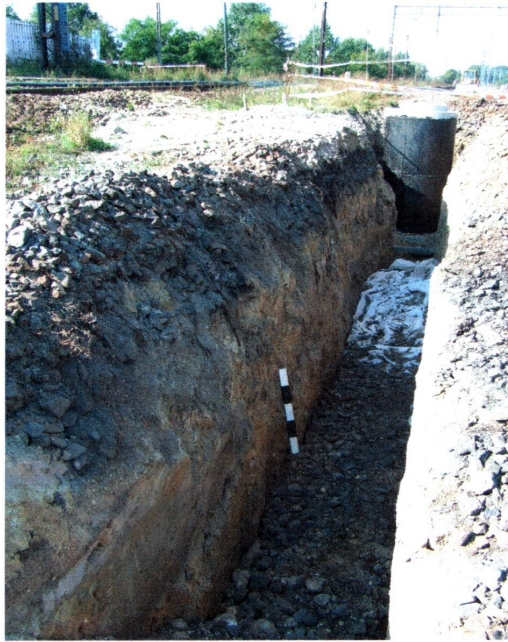
fot. 5 Fragment wykopu pod odwodnienie w północno-wschodniej części inwestycji, profil P1 (S)
