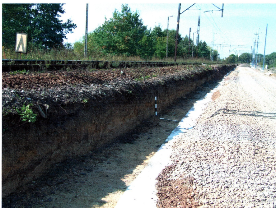
fot. 8 Prace przy wykopach pod układ torowy w zachodniej części inwestycji, na wschód od budynku stacyjnego, profil 2 (S)
