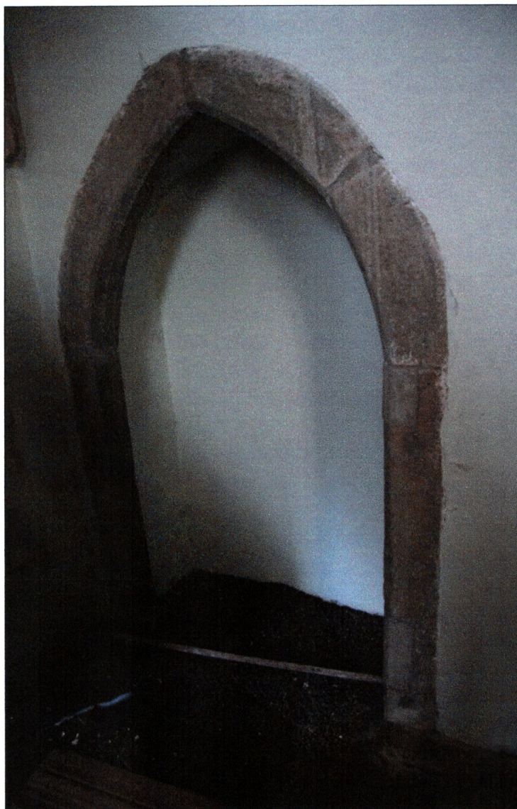
fot. 7 Piotrowice, gm. Kostomłoty. Wnętrze prezbiterium – portal dawnej zakrystii kościoła pw. Św. Katarzyny
