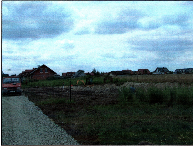
Fot. 3. Lutynia pow. Średzki dz. Nr 264/32. Obszar badań w trakcie wykonywania wykopów fundamentowych. Widok z północnego-wschodu
