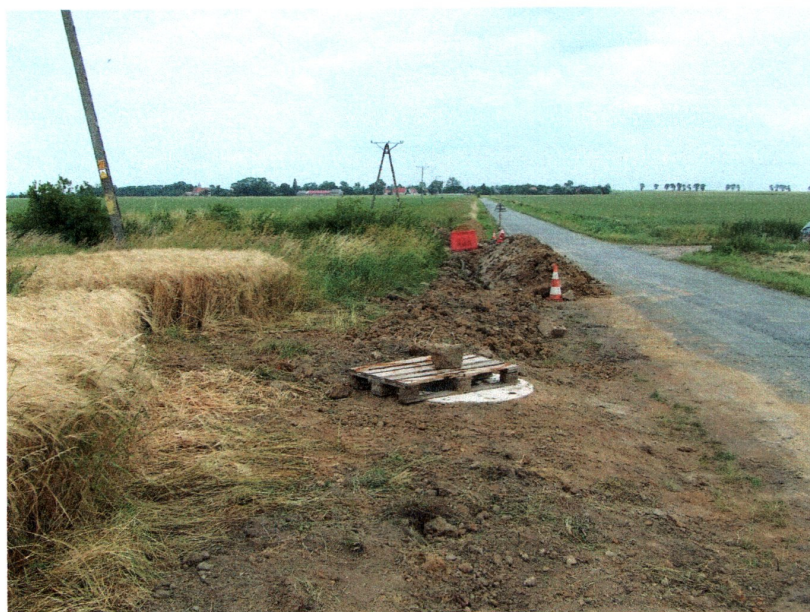
Fot. 7) Godków-Paździorno-Osieczyna gm. Kostomłoty. Rejon skrzyżowania drogi Godków-Paździorno z odgałęzieniem do Osieczyny. Widok z zachodu
