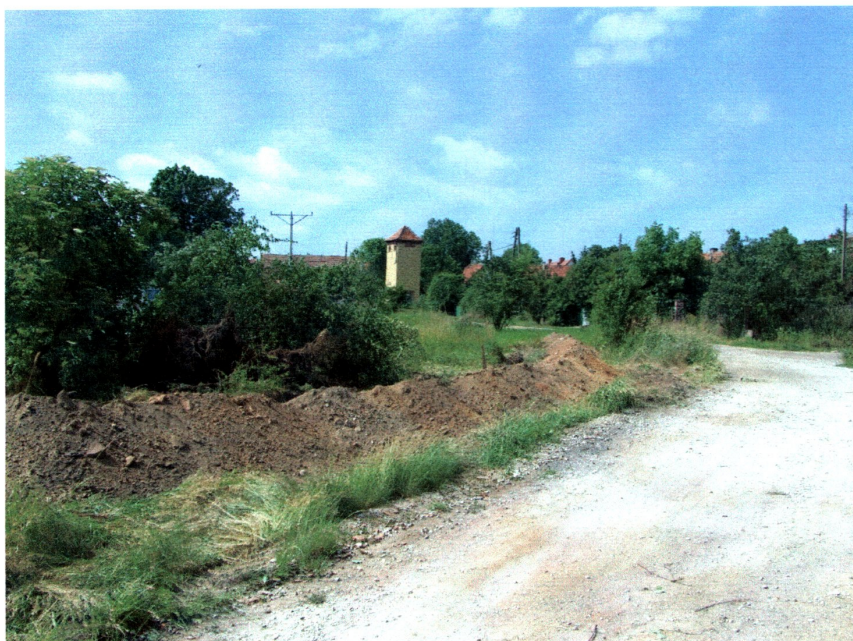
Fot. 1) Kostomłoty pow. średzki. Widok z północnego-wschodu na wykop instalacyjny u zbiegu ulic Klonowej i Akacjowej
