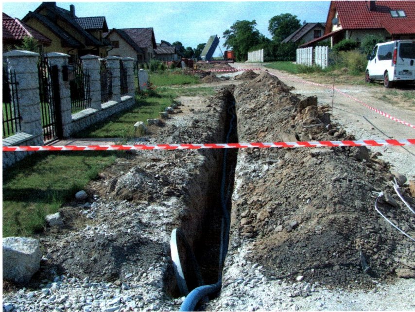
Fot. 11) Kostomłoty pow. średzki. Widok na wykopy instalacyjne w ulicy Sportowej w kierunku zbiegu z ulicą Wrocławską. Widok z północy
