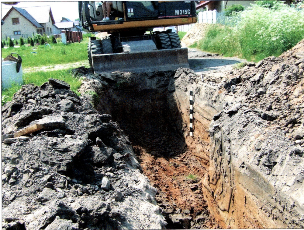
fot. 1 Nadzór nad pracami w północnej części inwestycji, na wysokości działki nr 199
